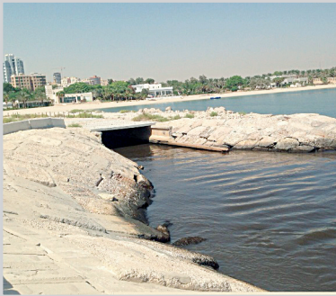
صورة توضح مجاري الأمطار
